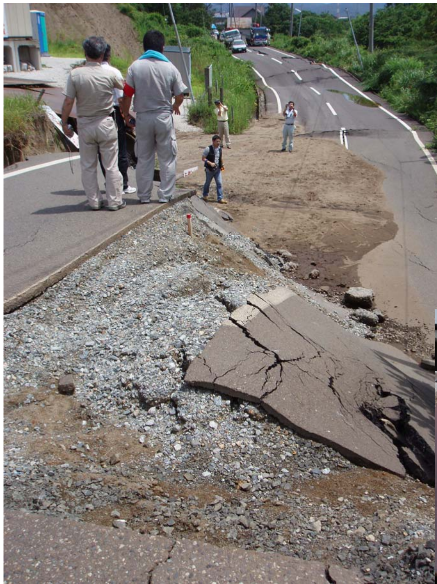
手前の道路が元の道路面。先の道路面が陥没した。 高さ3.0m、長さ50mにわたって地盤が砂地のため崩壊
