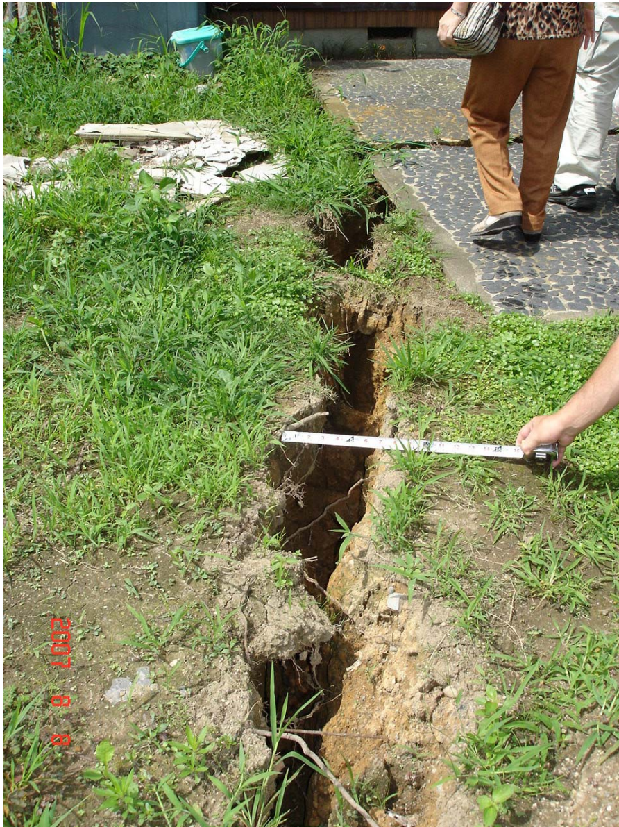
庭地割れ 100~180(この地割れが家の中を走っていく)
