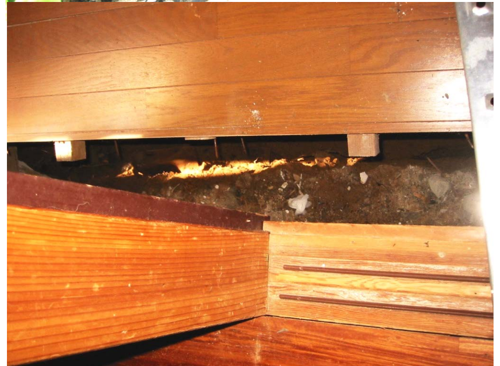
廊下と部屋が地割れにより引き離されている
