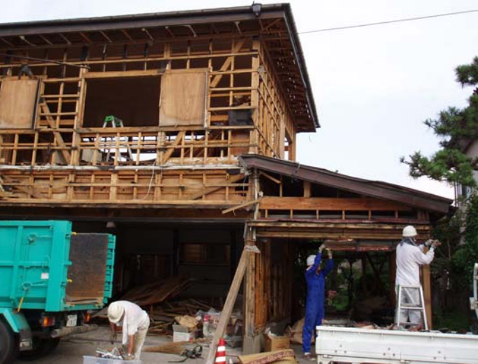
道路側に倒壊寸前 つかえ棒で支えている 基礎 無筋コンクリート
