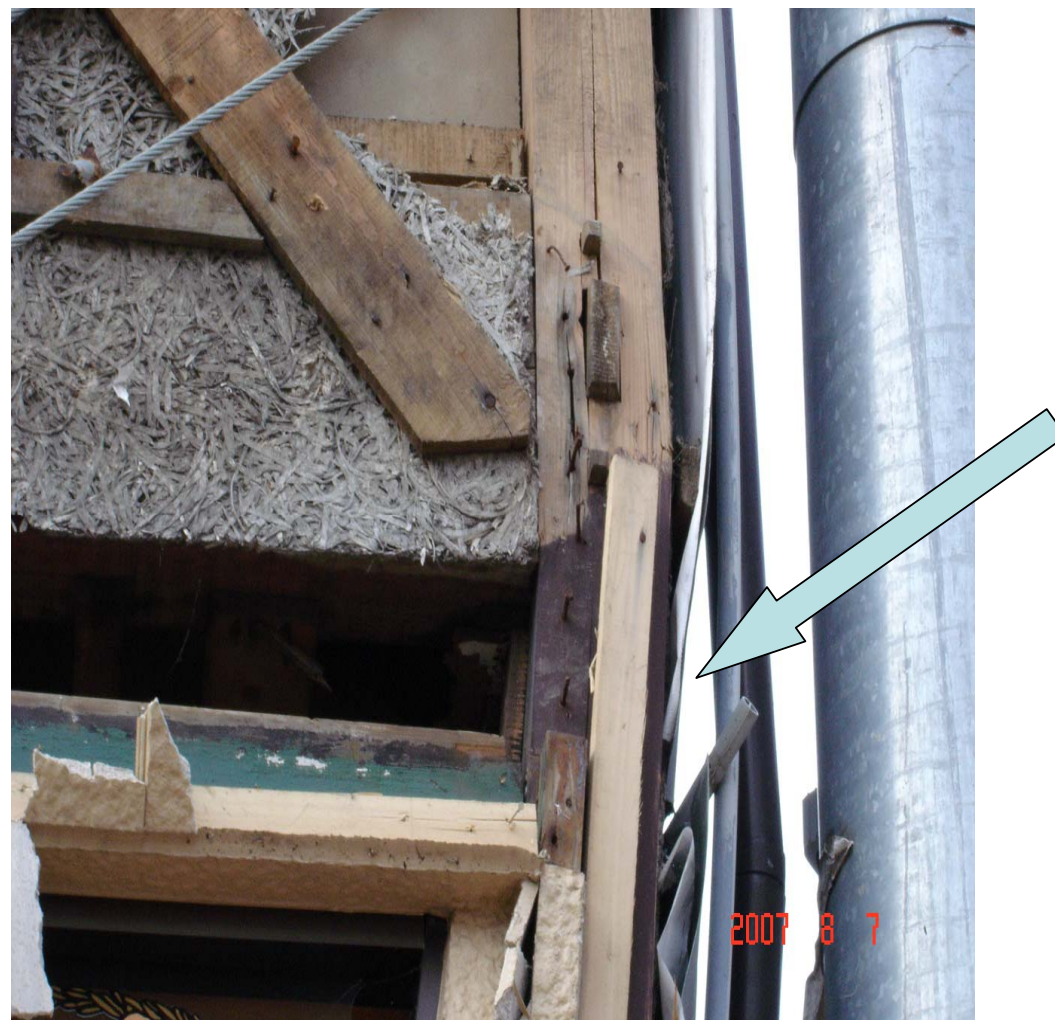
同 通し柱が胴差し下端の位置で折れている。
