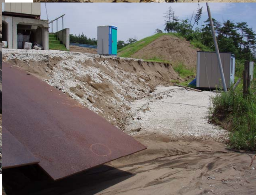
砂取場の路面補強鉄板が垂れ下がっている。
