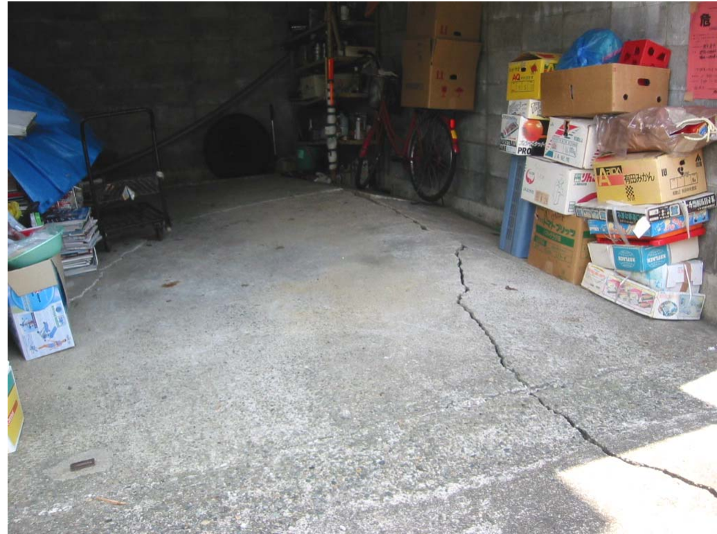
道路を挟んだ前の家 車庫土間亀裂
